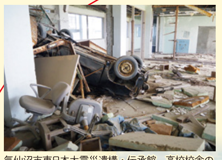
気仙沼市東日本大震災遺構・伝承館。高校校舎の4階に流れ着いた自動車が残る
